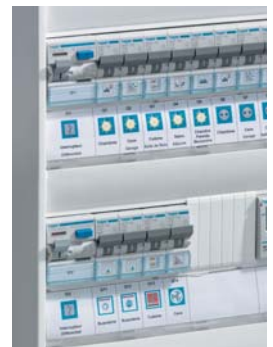
Repérage des circuits dans les coffrets
